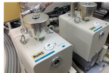
消耗品交換後のロータリーポンプ
