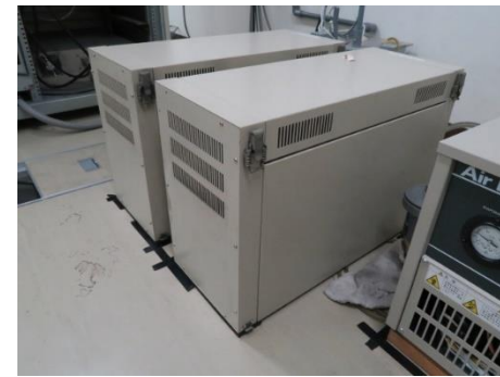
図7 NMR600用コンプレッサー (ダイヤフラムポンプ)
