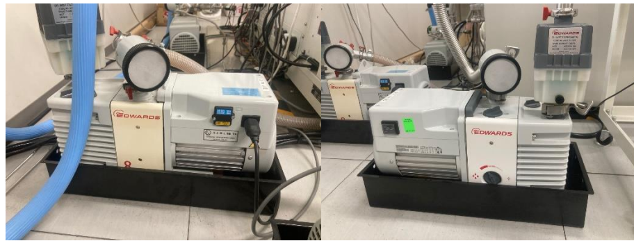
図5 XPS用真空ポンプ(エドワーズ RV8, RV5)
